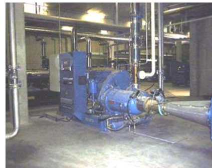
Figure 5 : Intérieur de la centrale (compresseurs centrifuges, ses auxiliaires et réseaux)
